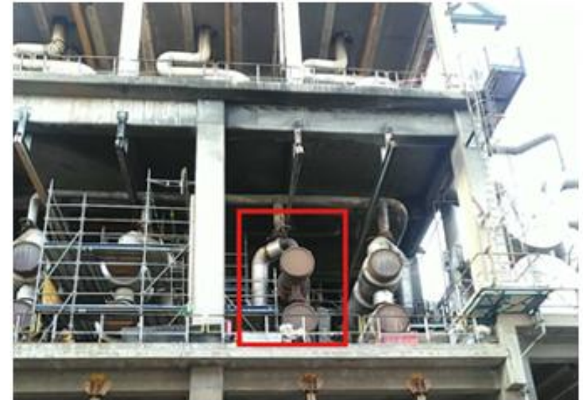
NB : Photo prise après l'incendie
